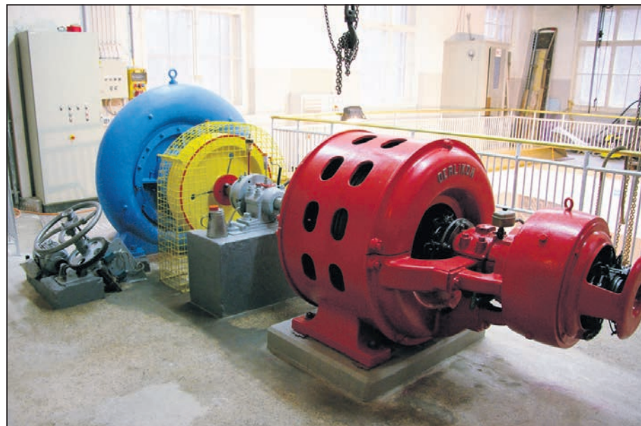
Die alte Francis-Turbine mit Generator (Amrein) von 1918 wurde ausser Betrieb genommen und steht als Zeitzeugin im Generatorenraum.
