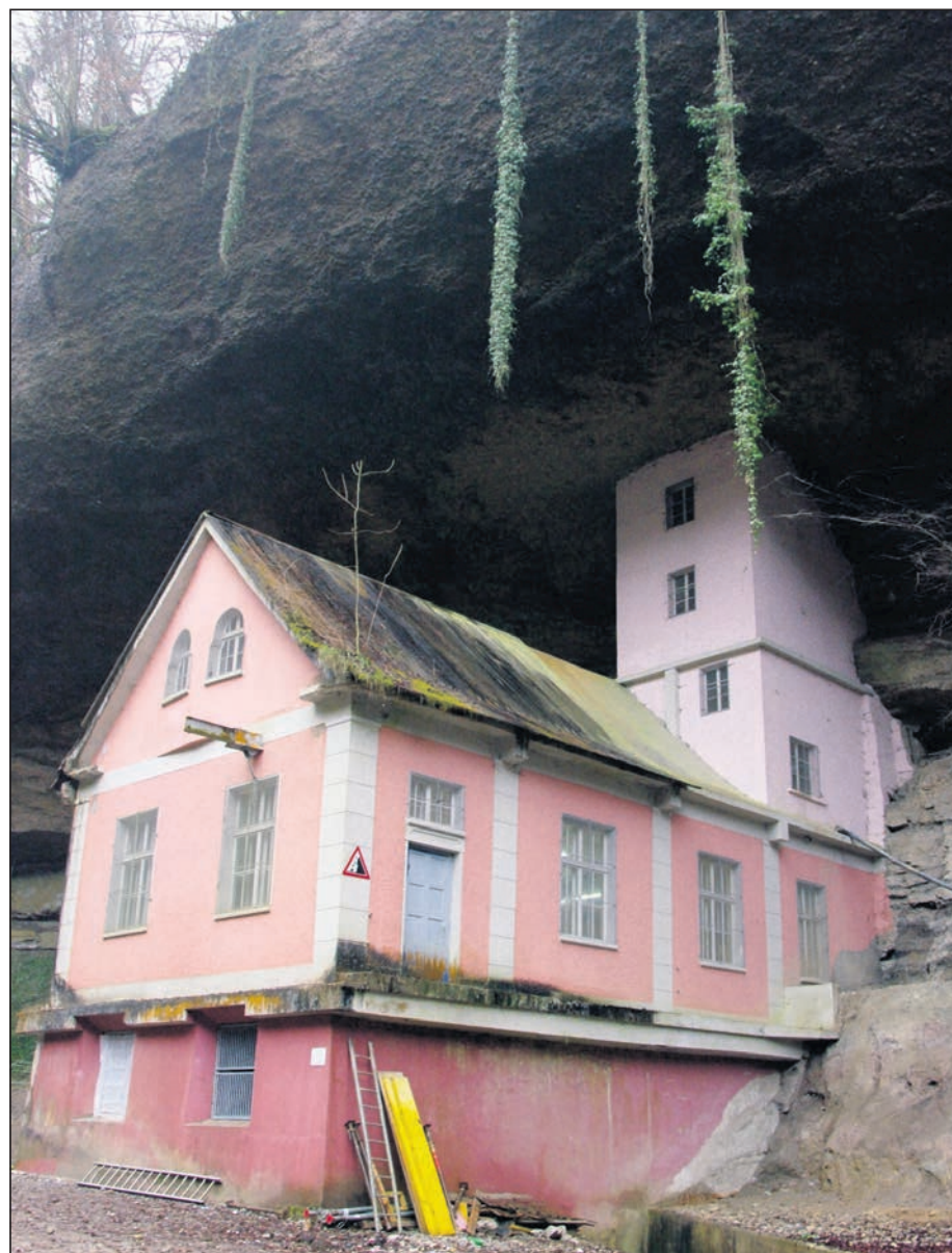
Das unter Heimatschutz stehende Turbinengebäude, das unter die Felswand des Pilgerstegs gebaut wurde.
