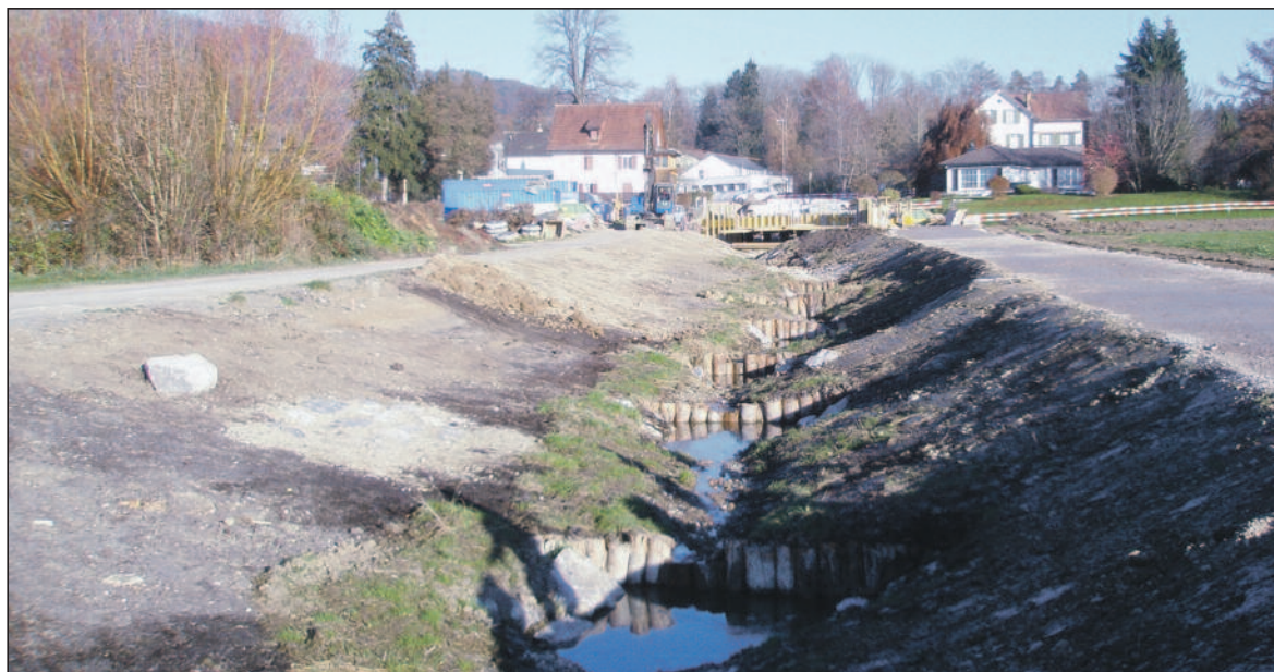
Das Bett des offen gelegten Bachs wird mit Rundhölzern und Steinen gesichert. Das Gefälle wird durch querliegende Schwellen aus Pfahlreihen gebrochen. Auf der linken Seite ist der Possengrabenweg, rechts die Fortsetzung des Schachenrietwegs und die im Bau befindliche Brücke (17. 11. 2011).
