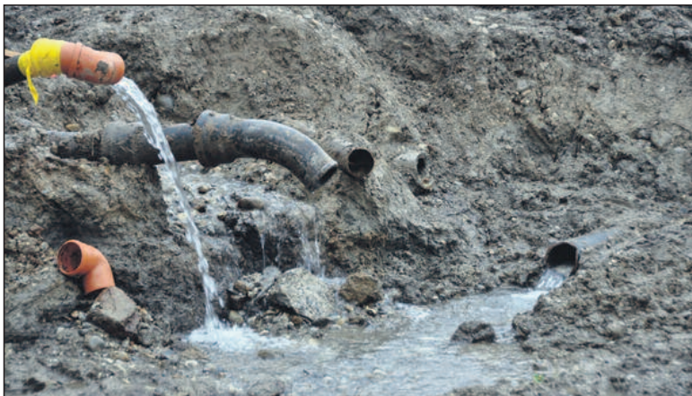
Während des Umbaus fliesst das Wasser der Brunnenbühl-Quelle (grosse Röhre hinten, unten) und der Herrenholz-Quelle (kleine Röhre links oben) in den Nauenweiher.
